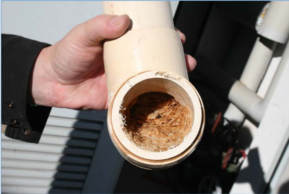
Abb. 1: Ablagerungen führen nach und nach zur völligen Blockierung der Rohre.
